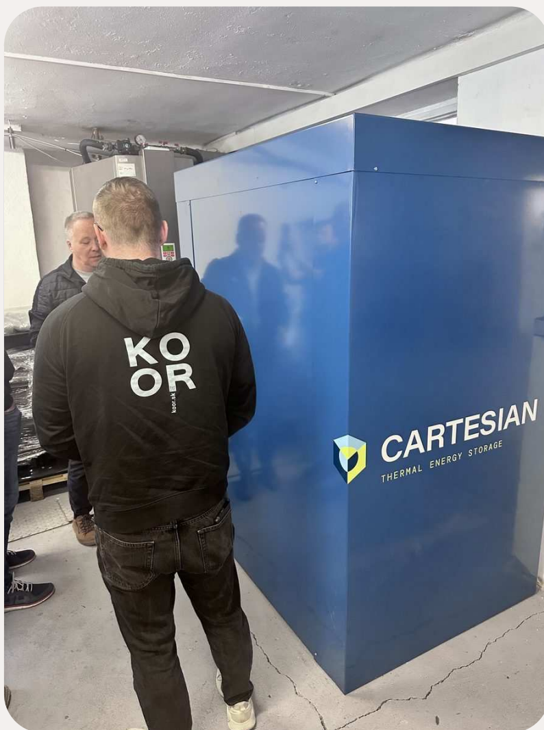
Thermal Box (75 kWh / 37 °C) v testovacej prevádzke u výrobcu tepelných čerpadiel TČ Mach v Moravskom Krumlove
